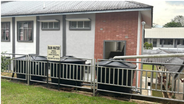
Gambar 2: Sistem penuaian air hujan yang telah dibangunkan di Sekolah Kebangsaan RPS Pos Kemar
